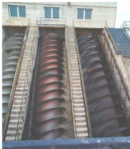
Fig. 11 – Fase di sollevamento dei liquami grezzi in ingresso ad un impianto di depurazione.
